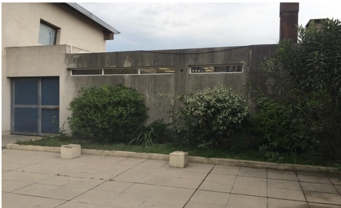
Fachada con falta de pintura, carpinterías corroídas- Tramos de bancos de hormigón robados
