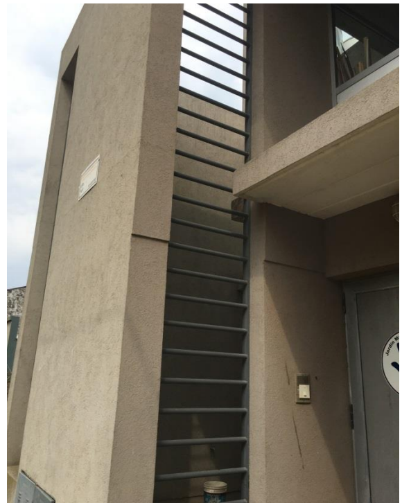
Detalle de reja que permite acceso para vandalismo----- -----
