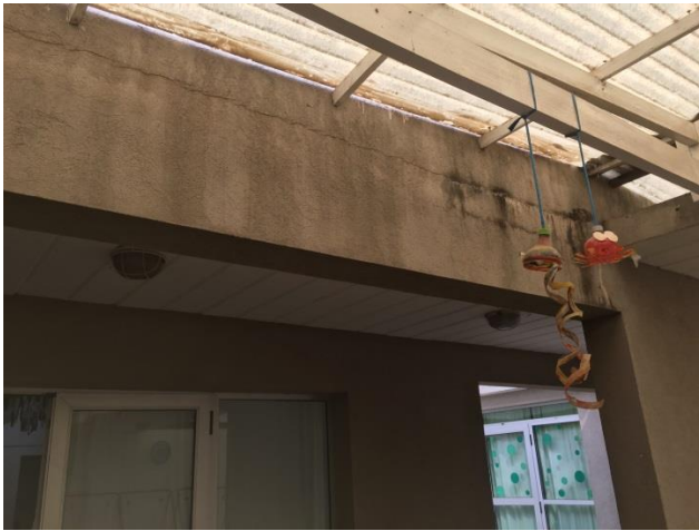
Grieta en viga
